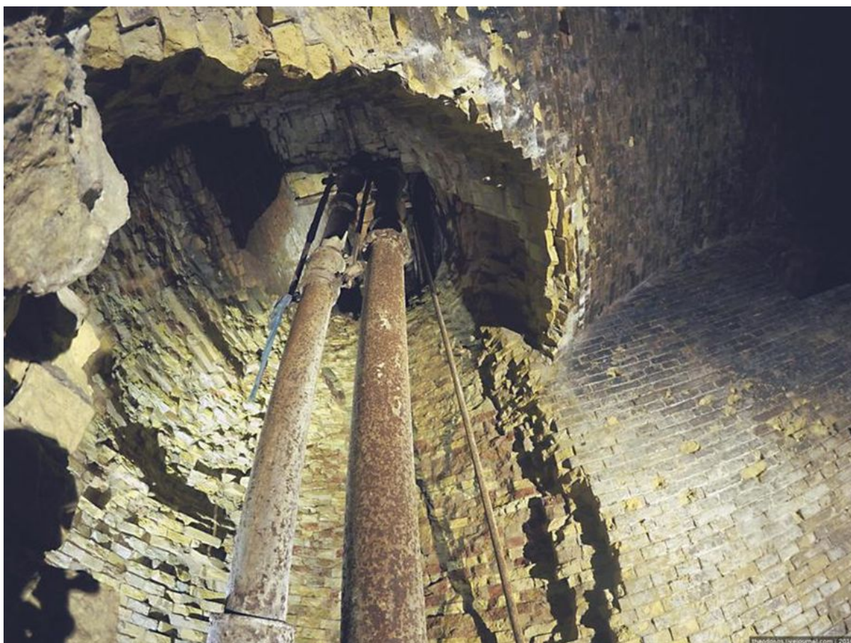
Водопровід у верхній напівкруглій стінці
